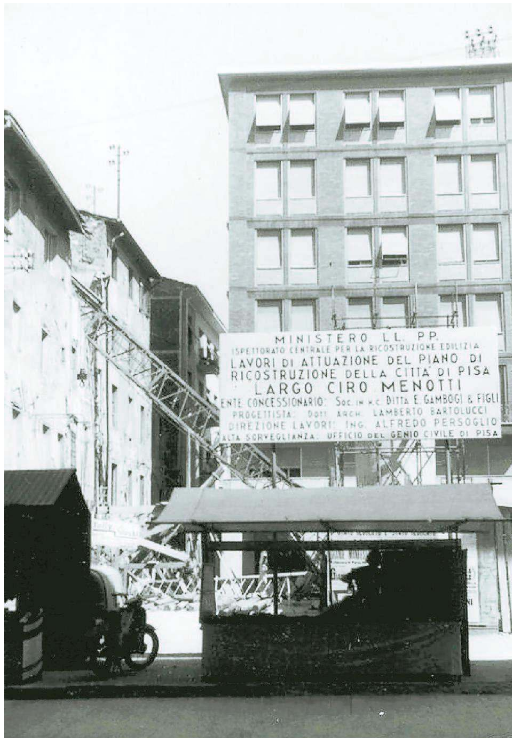
Una gru crollata durante i lavori di ricostruzione di quello che diverrà Largo Ciro Menotti
