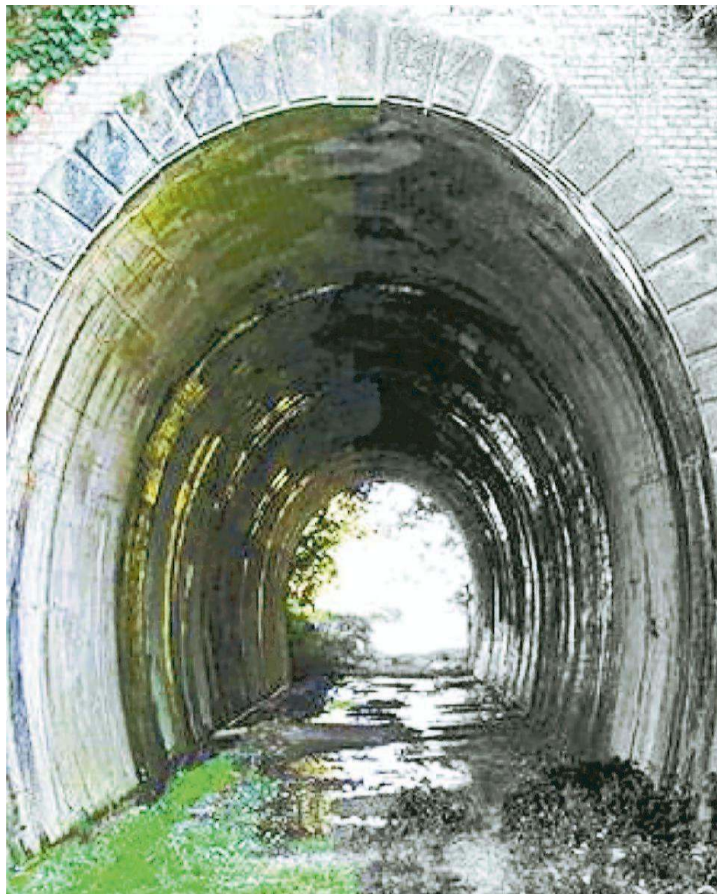
La galleria subalvea del torrente Visona a Castelvecchio di Compito
