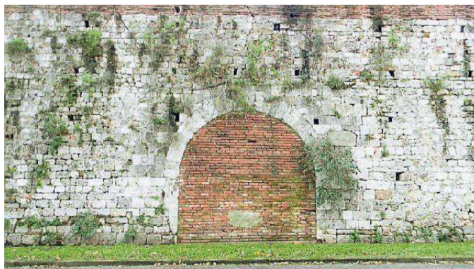
Le Mura sud necessitanti di riqualificazione
